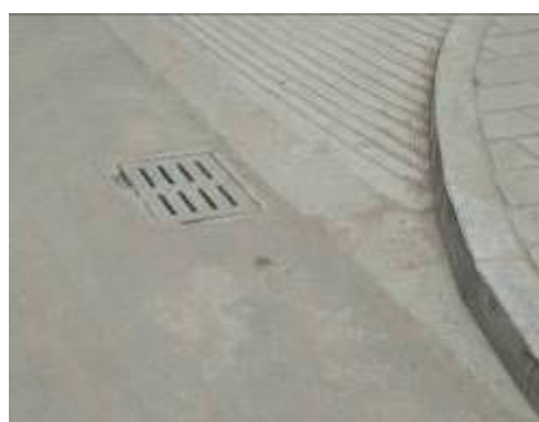
场地内道路下埋设排水暗管
