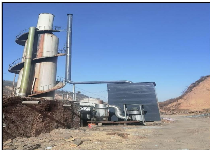
现有工程烟气处理设施
